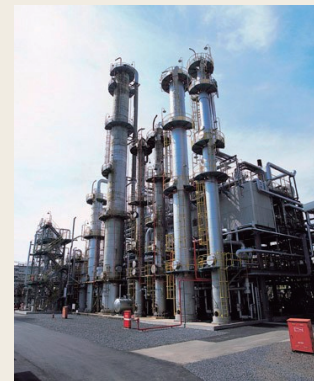
酢酸エチルの集約化を図った日本酢酸エチル・大分の酢酸エチル製造設備
