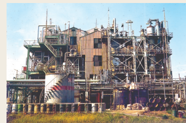
三井東圧化学・名古屋のビスフェノール A 製造設備
